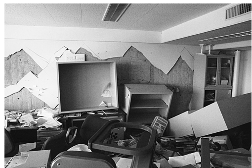
写真1 崩れ落ちた壁と本棚（学生居室）
