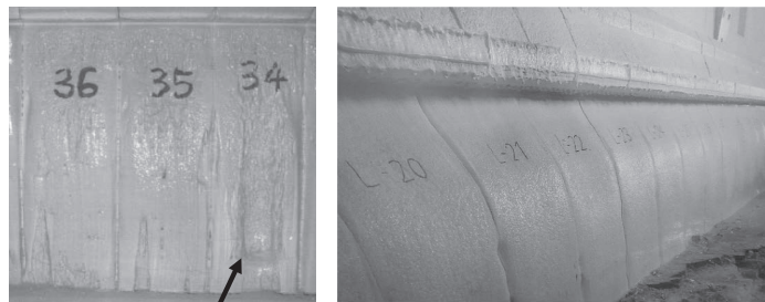
異常侵食(上方侵食)
